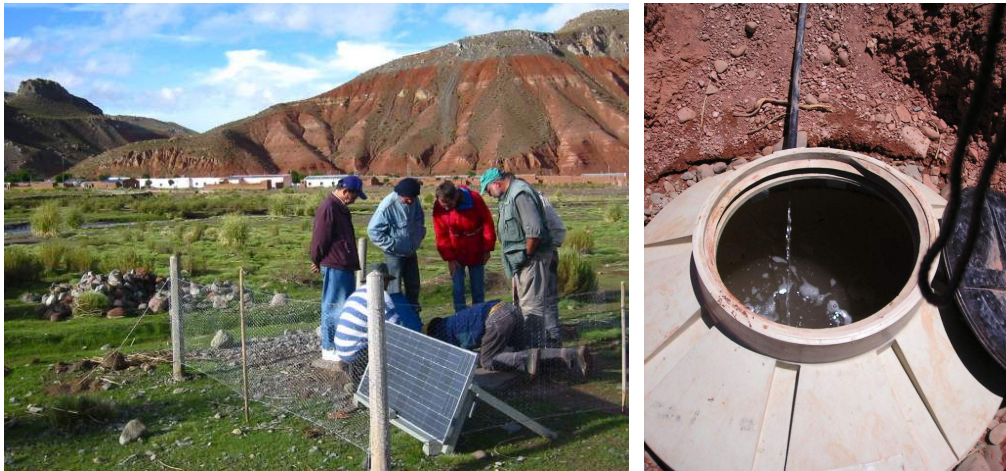
Figura 11: Bomba a energía solar utilizada para el riego y un tanque de agua con capacidad de 1000 litros en Ciénaga
