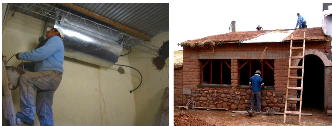
Figura 5: Acumulador de agua caliente en Cusi Cusi y sala de baño comunitaria
