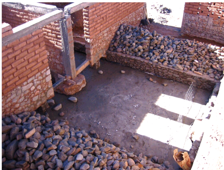
Abbildung 5-3: Im Fußboden integrierter Kiesbettspeicher vor der Befüllung im Kindergarten von Cienaga
