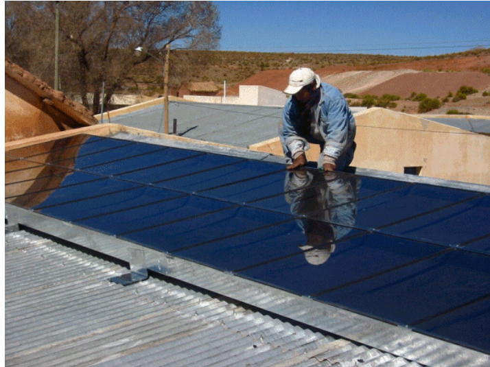
Abbildung 4-7: Installierter Prototyp auf dem Haus des Kindergartens in Cusi Cusi
