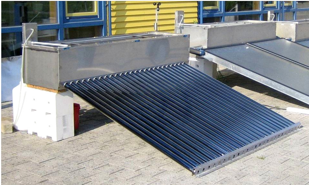
Abb. 13-4: Entsalzungsanlage mit Vakuumröhrenbetrieb
